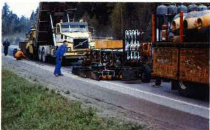
Kuva 69. Tehokaasu Oy:n versio, jossa kaksi kuumenninta on kytketty yhteen kuorma-auton vedettäväksi, 1976.
